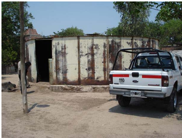
Antiguo tanque de combustibles que actualmente funciona como depósito de plaguicidas obsoletos.
