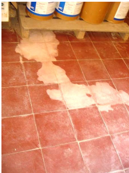
Arriba (izq.): Mancha producto de un derrame en el interior del depósito de plaguicidas.
