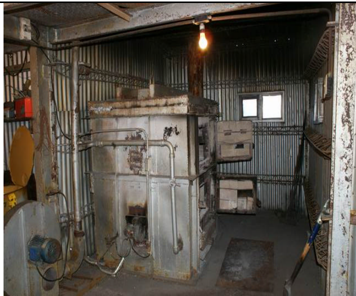
Incinerador de la Base Jubany, al momento de la verificación in situ.
