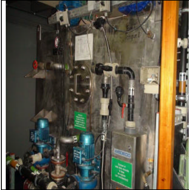
Planta de tratamiento de efluentes cloacales de Base Jubany.
