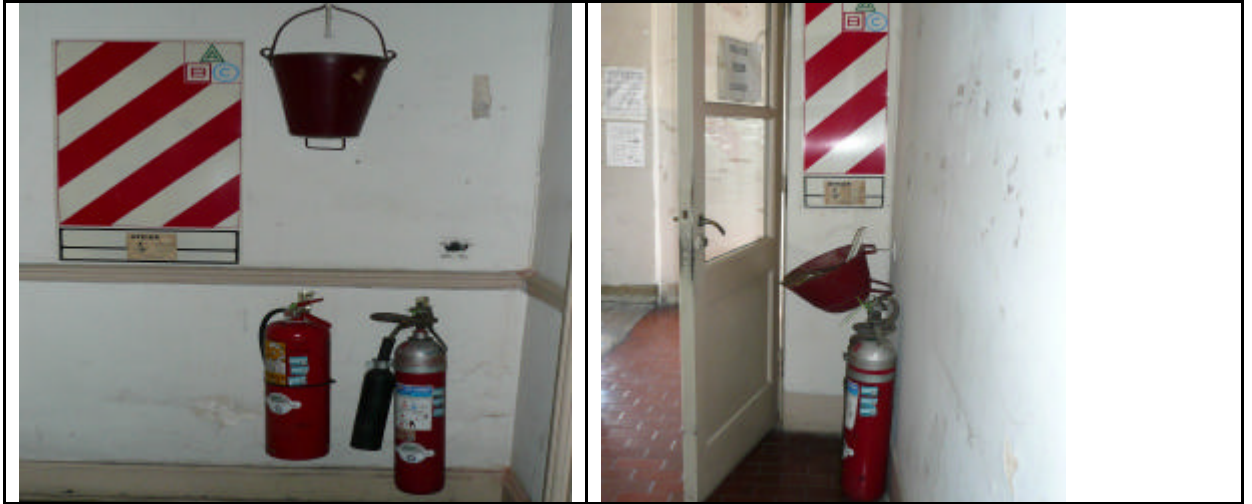
Los matafuegos no se encontraron instalados en forma adecuada.
