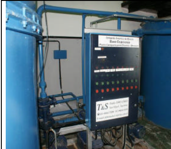
Planta de tratamiento de efluentes cloacales de Base Esperanza.
